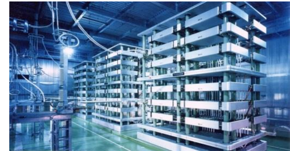
紀伊水道HVDC変換器
